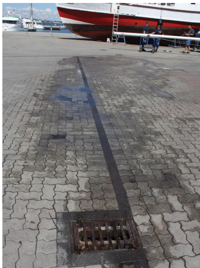
Abb. 3 Waschplatz mit Ablauf zu einem Zwei-Kammersystem
