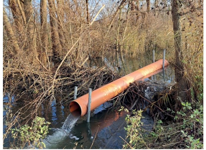
Abb. 24: Der Einbau einer Dammdrainage zur Reduktion des Wasserstandes kann im Einzelfall genehmigungspflichtig sein. (Foto: Julia Putze)
