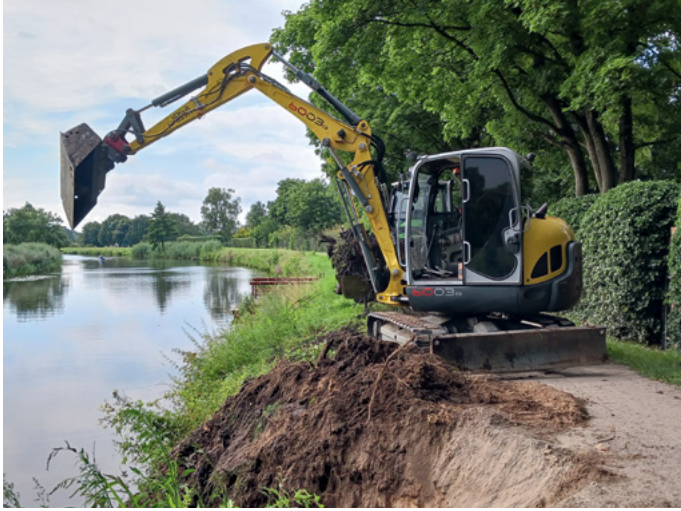
Abb. 23: Bei der Unterminierung von Deichen können Maßnahmen zur unmittelbaren Gefahrenabwehr notwendig sein. (Foto: Ingo Weinrich)
